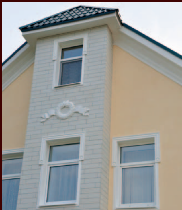
Комплектация объекта: "Фэшн-Дорз", Екатеринбург
